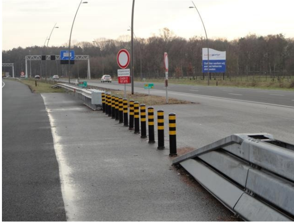
Foto 6 – Doorsteek met overrijdbare paaltjes op A2 bij Eindhoven
